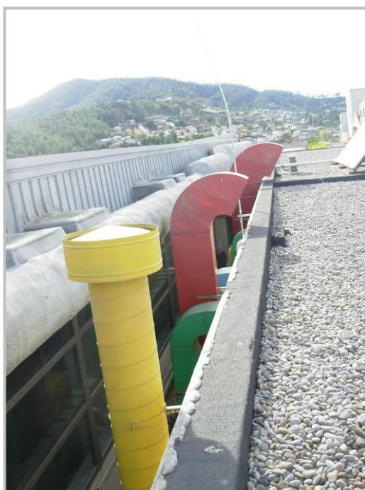
Figura 7 Passadís exterior de serveis per on circula el conducte de retorn de la bomba de calor deshumectadora i on es troben els equips de clima i alguns dels equips d'aire condicionat
