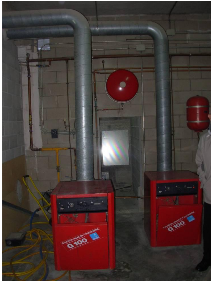
Figura 8 Sala de calderes
