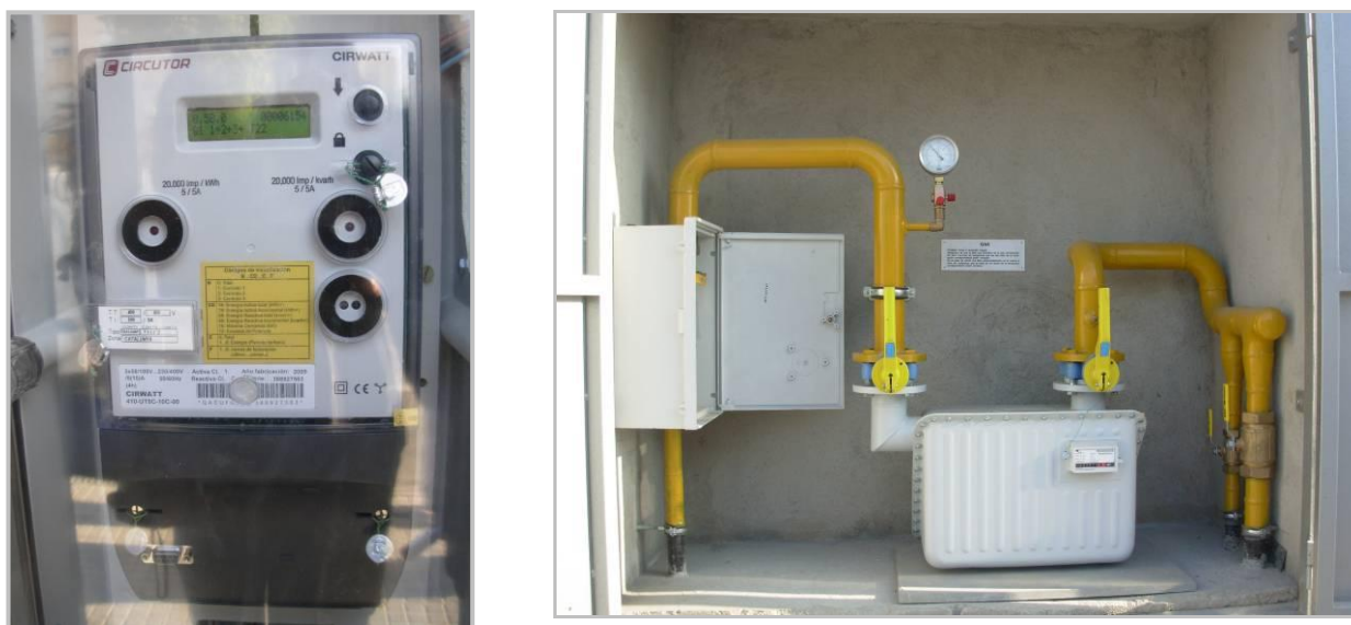
Figura 7 Comptadors energia elèctrica i gas natural
