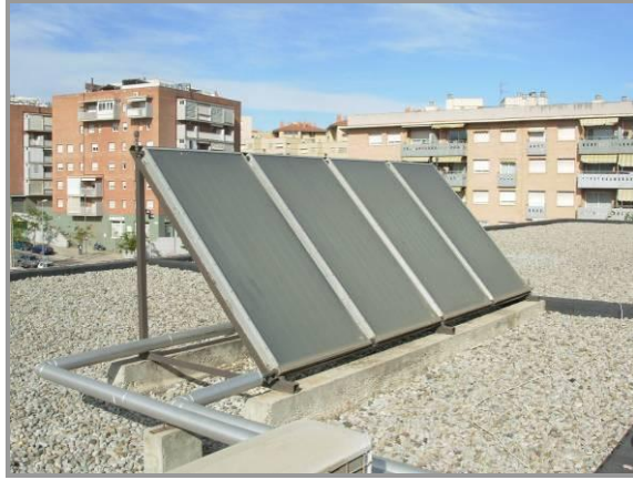
Figura 14 Plaques solar tèrmiques fora d'ús
