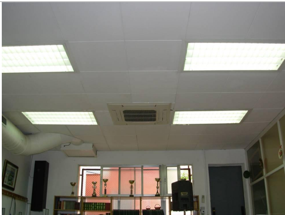
Figura 5 Il·luminació amb fluorescents i split de climatització
