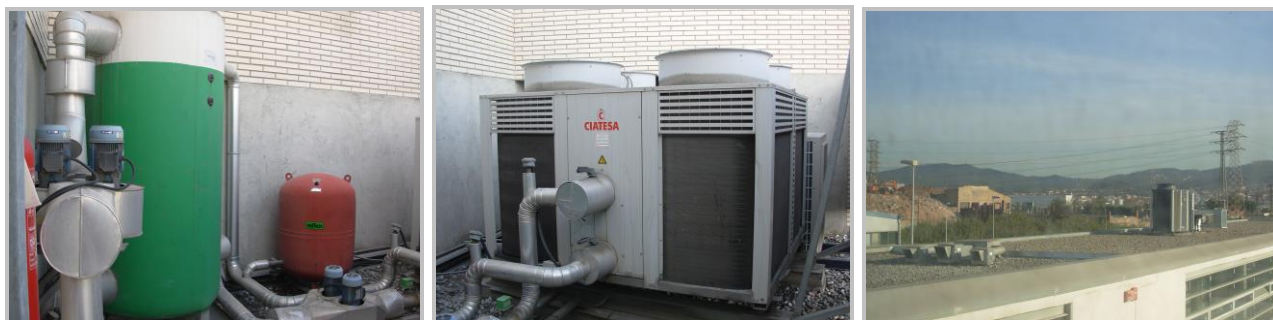
Figura 6 Acumulador (esquerra). Màquines fred-calor dependències municipals ( dreta). Màquines fred-calor locals annexos (fila inferior)
