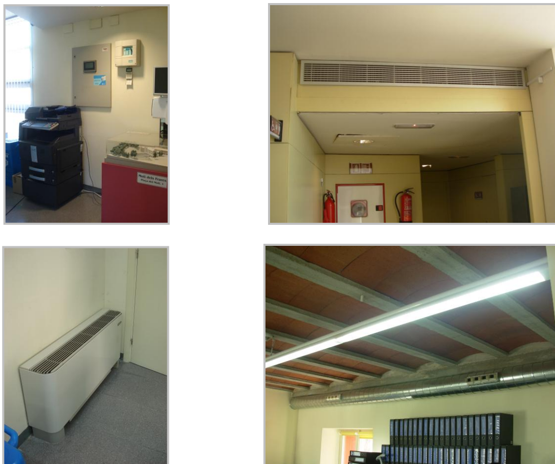
Figura 7 Sistema regulació temperatures del sistema de climatització (esquerra). Emissor sistema climatització (centre i dreta)
