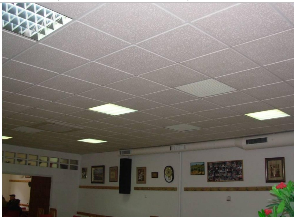
Figura 6 Il·luminació amb fluorescents i split de climatització
