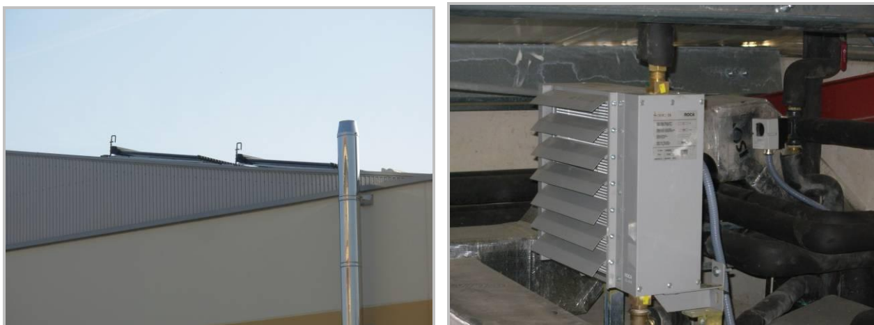
Figura 6. xemeneia caldera gas natural i plaques solar (esquerra) arotermo-disipador instal·lació captació solar (dreta)
