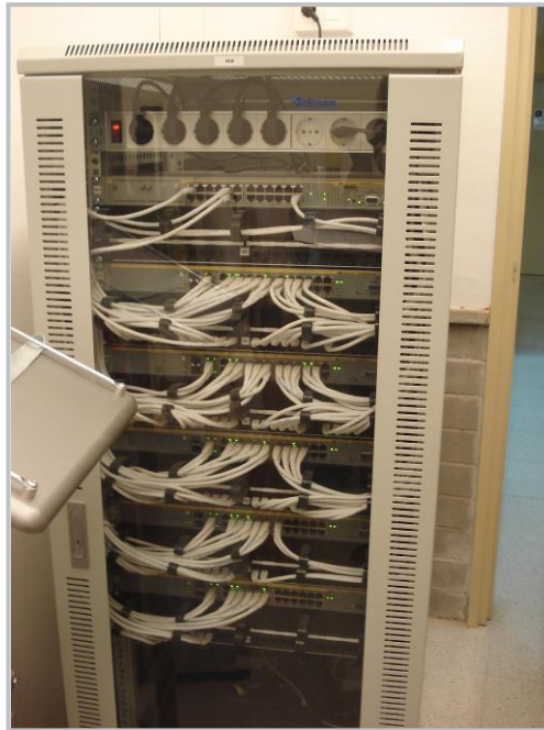
Figura 8 Rack de connexions de xarxa
